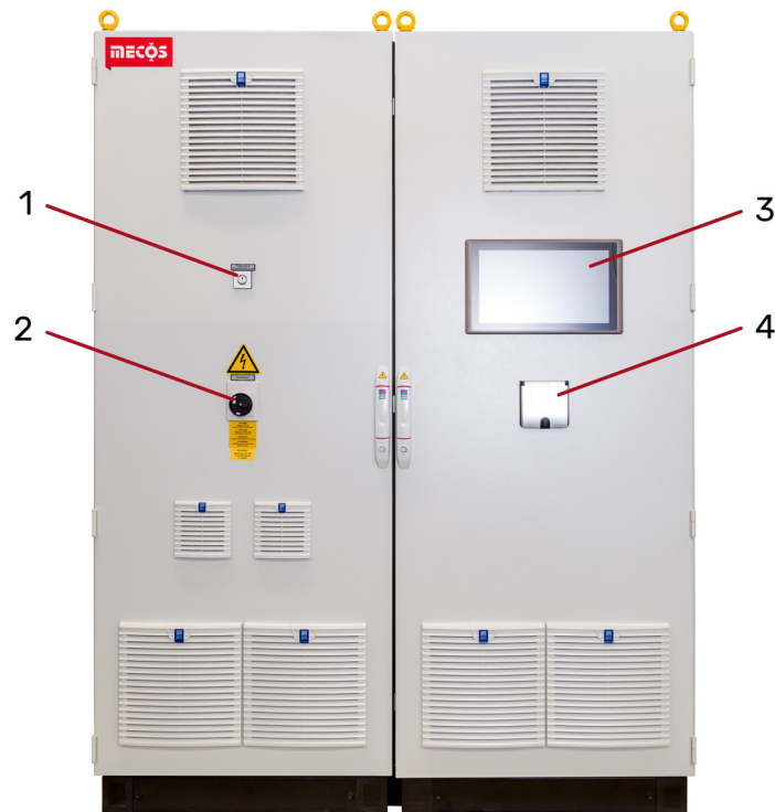
Abbildung 6: Aussenansicht AML Schaltschrank MBX22 in der Standard-Konfiguration
